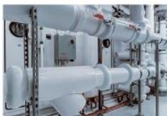
機械・配管設備
